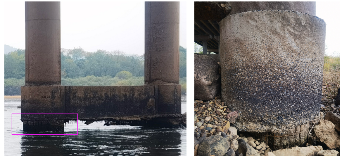
桩基保护层混凝土剥落、钢筋外漏锈蚀
