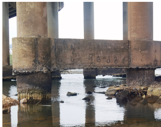
桩基保护层混凝土剥落、钢筋外漏锈蚀(9#)
