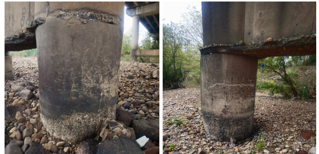
桩基混凝土水泥砂浆冲蚀、骨料外漏
