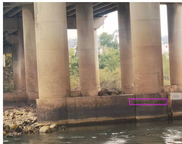
桩基混凝土开裂、破损（7#）
