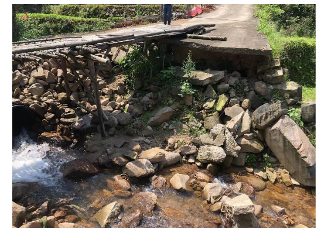
涵洞衔接路段受损
