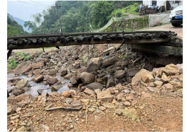
涵洞衔接路段受损
